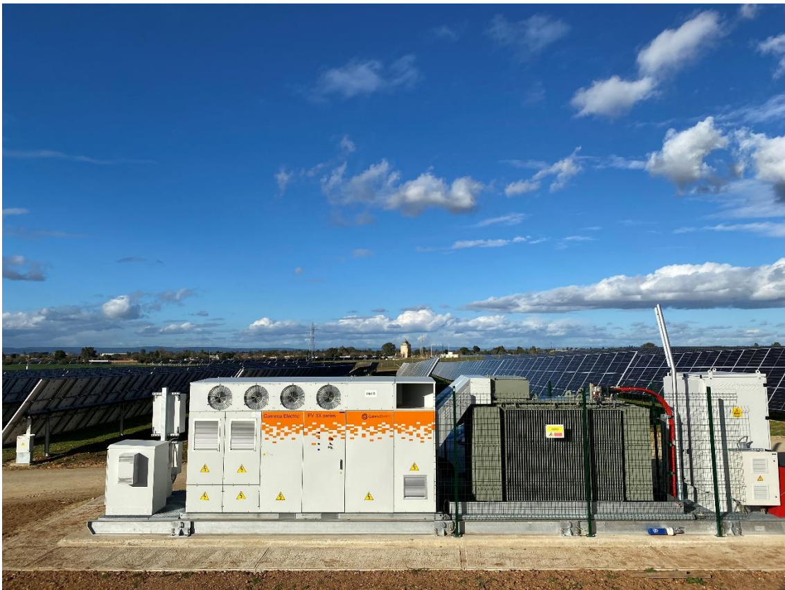
Imagen Superior: Estación Gamesa Electric PV 3X series instalada en una planta solar en España.
